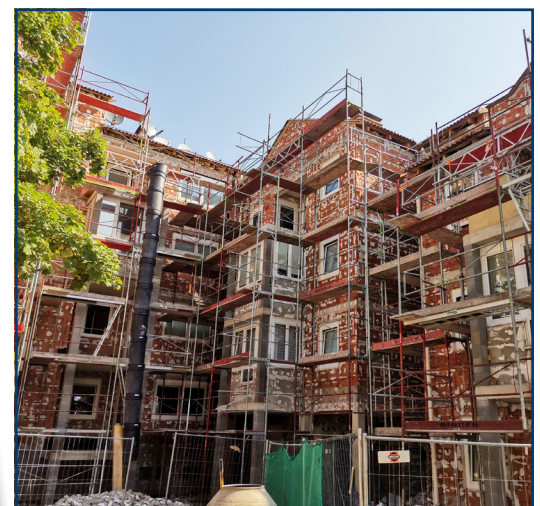
In der Raaberbahngasse werden die Genossenschaftswohnungen saniert. Auch das ist ein Projekt, das vom Land Niederösterreich finanziell unterstützt wird.
